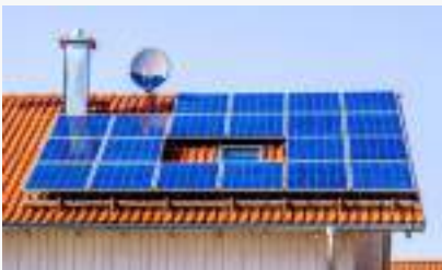
Proyecto solar residencial en Chumphon, Tailandia de 30 kW
