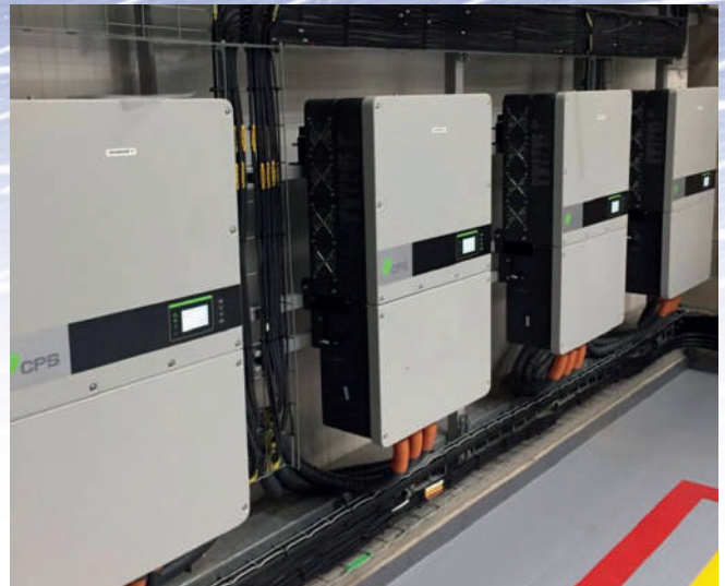
CPS 206.4 kWp - Proyecto Ventanar - Colombia
